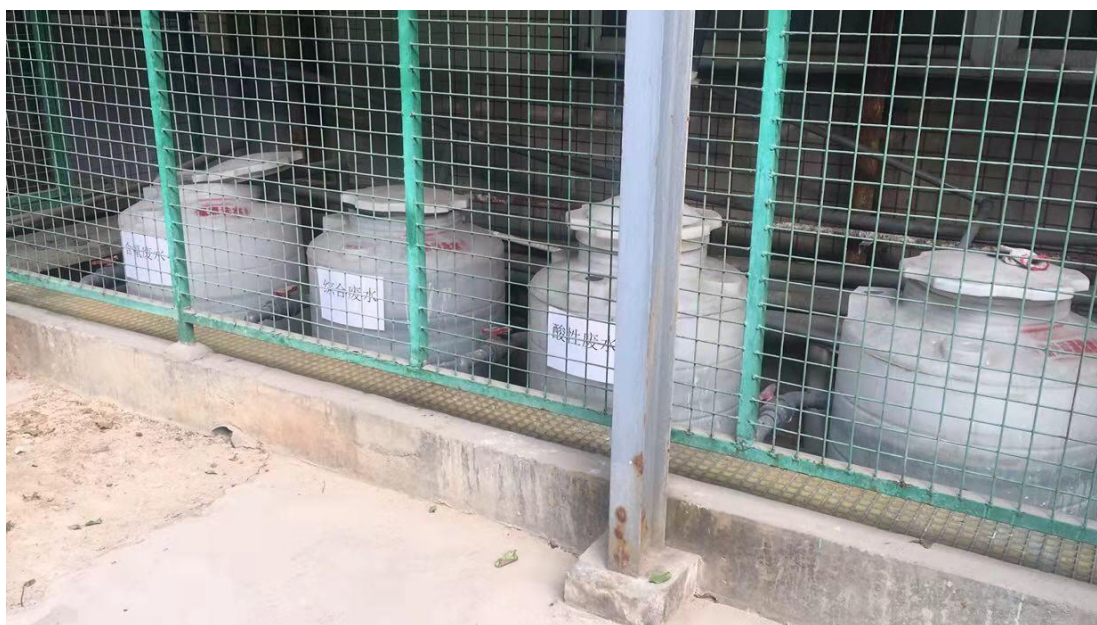
图 7.1-2 废水分类收集罐照片
